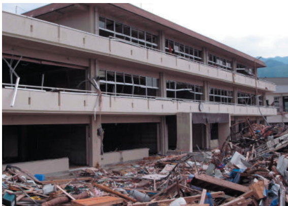
津波により被害を受けた校舎
